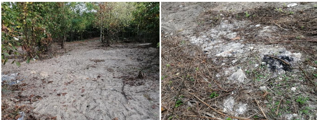
Photo 1 – Remaniement dans la zone Nord-Ouest du site et déchets de construction enfouis
