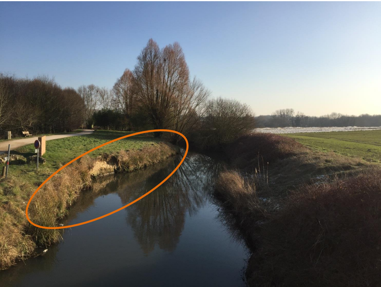
Figure 11 - Déstabilisation de la berge gauche de l'Yvette en aval du pont de la route de Champlan
