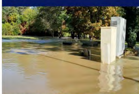
Poste de relèvement à Saint-Rémy-Les-Chevreuse
